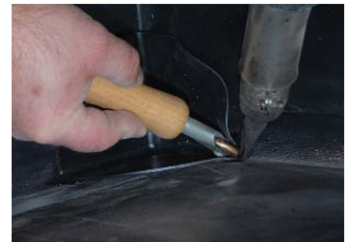
▲ Der Anschluss der Bahn an die Edelstahlbleche wird per Heißluftfön ausgeführt. Für die Ecken empfehlen sich passende Formteile
