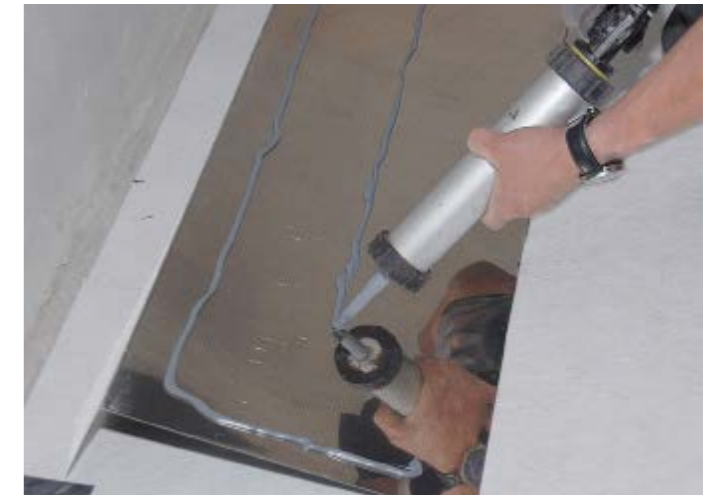
▲ Als Fixierung dient rückseitig ein Montageklebstoff. Die Edelstahlbleche müssen nur an den Profilen mechanisch fixiert werden
