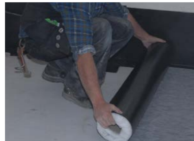
▲ Danach wird als Abdichtungsebene die Kunststoffbahn ausgerollt und ausgerichtet. Sämtliche Nähte müssen homogen verschweißt werden
