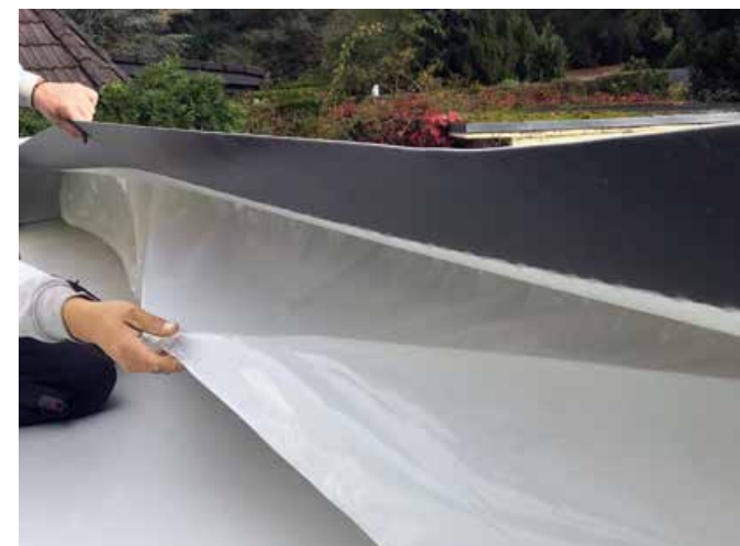
▲ Die Verarbeitung selbstklebender Detailabdichtungsbahnen bringt auf der Baustelle eine enorme Zeitersparnis mit sich
