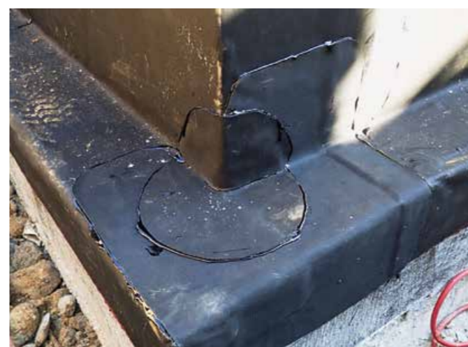
▲ Das Anfertigen und Aufschweißen solcher separater EPDM-Zuschnitte dient der sicheren und materialhomogenen Eckausbildung
