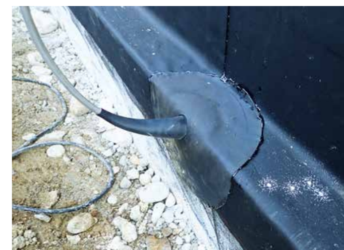
▲ Sonderfall im Detail: Eindichtung einer Kabeldurchführung mit separater, aufgeschweißter Stülpmanschette
