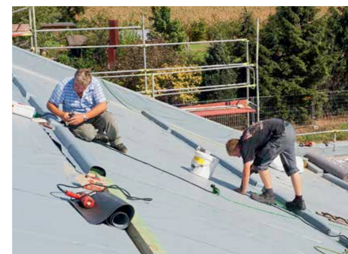
▲ Sonderfall Steildach: Hier muss die Kunststoffdachbahn verklebt oder mechanisch befestigt sowie durch Schubschwellen ergänzt werden
