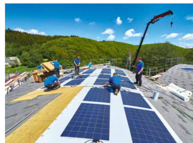
▲ Strom vom Industriedach: Verlegung von Solardachbahnen, die ebenfalls mechanisch befestigt und mit Heißluft gefügt werden
