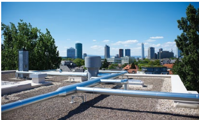
Bild 8. Für die Lagesicherung kann auf einem Industriedach beispielsweise eine Kiesschüttung dienen.
