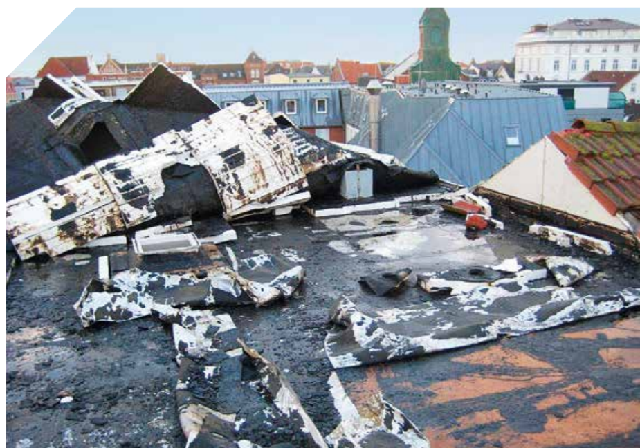
▲ Sturmschaden auf Norderney: Dieser Flachdachaufbau wurde durch Windsog komplett abgeräumt
